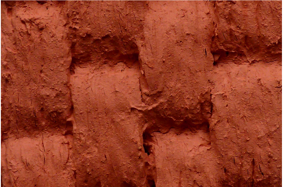
[6] Feine Risse entlang der Einbuchtung
